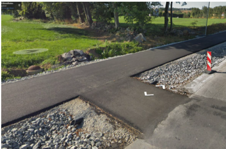
Asfaltert kryssing av grøft som foreslås å etablere sammen med busstopp kun skiltet med holdeplass.
